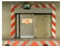
Cross Passage Door
