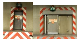
中央高速公路紧急疏散楼梯出口 中央高速公路横道通门
