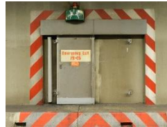
Cross Passage Door
