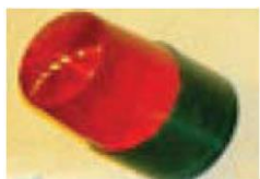
福康宁隧道（FCT）/兀士维隧道（WVT）-在紧急情况时，当您看到装置在服务柜旁墙壁上的红灯闪烁时，请立刻离开隧道。
