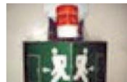
中央高速公路（CTE）-安装在门上的频闪灯。
