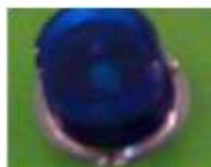
加冷-巴耶利峇快速公（KPE）/滨海高速公路（MCE）-安装在紧急疏散楼梯和横道通门旁的频闪灯。
